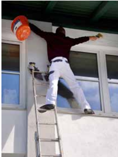
FALSCH Das seitliche Hinauslehnen kann zu schweren Unfällen führen.
