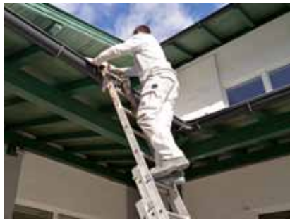
FALSCH Die Anlegeleiter entspricht nicht der erforderlichen Länge.
